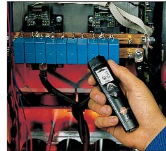
Kontrola teploty např. ve skříňových rozvaděčích
